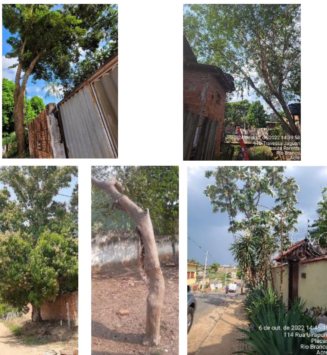
Figura 142. Árvores plantadas próximas ao muro de residências, algumas com risco iminente de queda.
