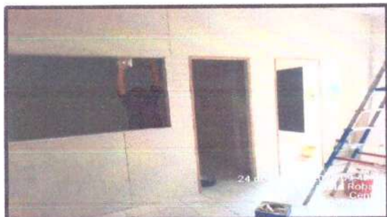
FOTO 05: DEFESA CIVIL – PREDIO DO MIRA SHOPPING
