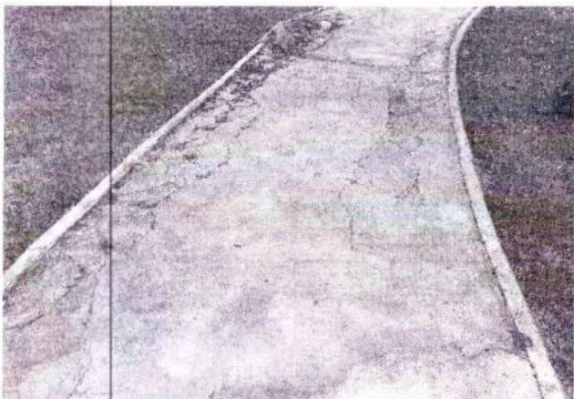
Foto 55- calçada antes da reforma
