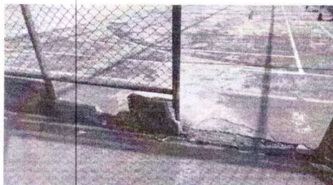
Foto 103 – mureta da quadra danificada
