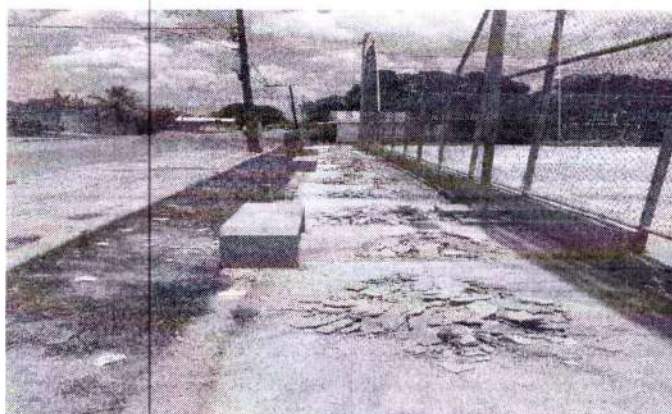
Foto 101 – calçada antes da reforma
