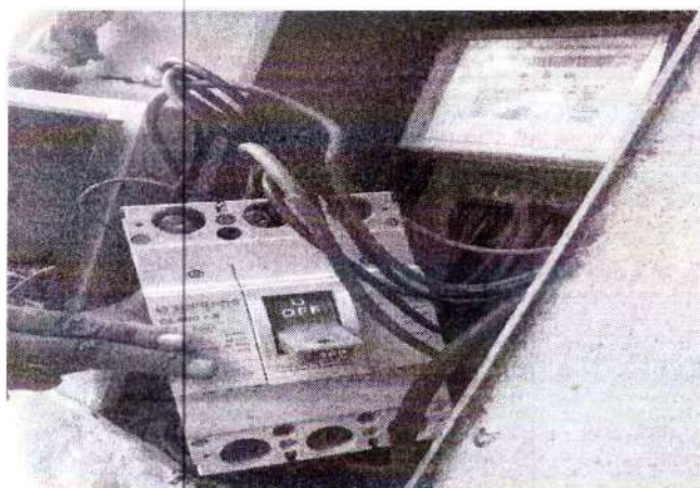
Foto 37: Parte elétrica (SEINFRA)
