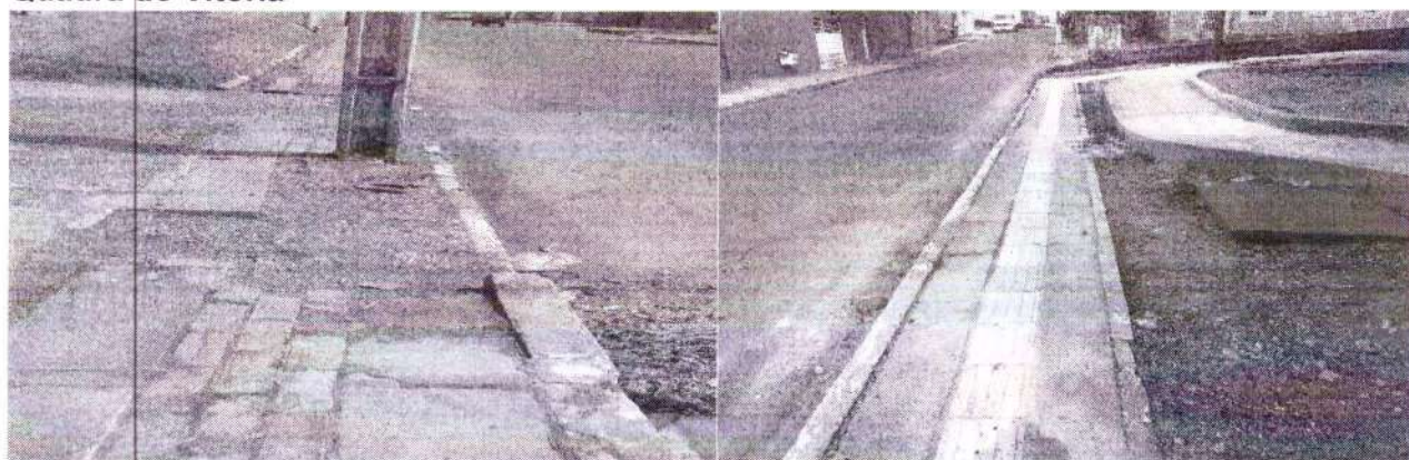
Foto 45 – calçada antes da reforma
