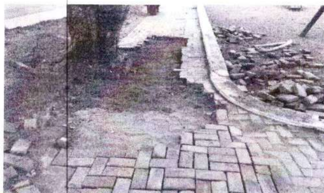
Foto 67 – calçada antes da reforma
