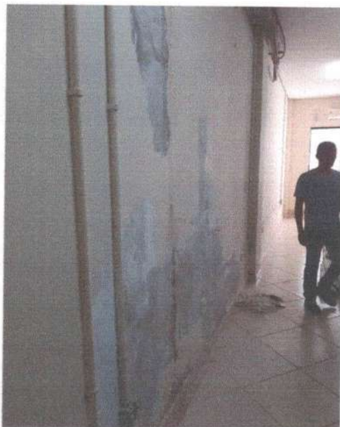
Foto 1: parede com mofo
