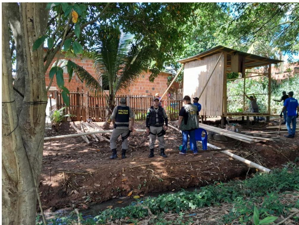
Imagem 11: Policiamento Ostensivo para demolição em área de preservação permanente.
